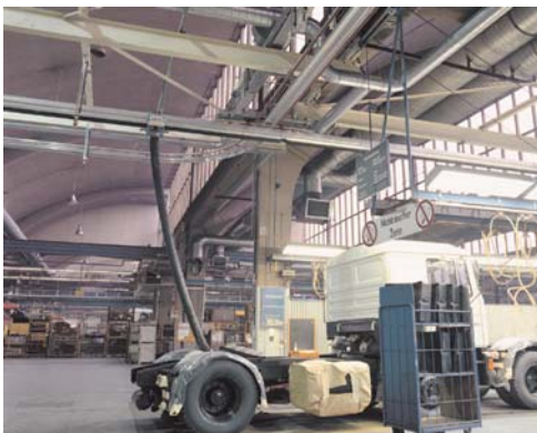
Installazione di Canalina Blindotubo con gruppi di aspirazione mobili.
