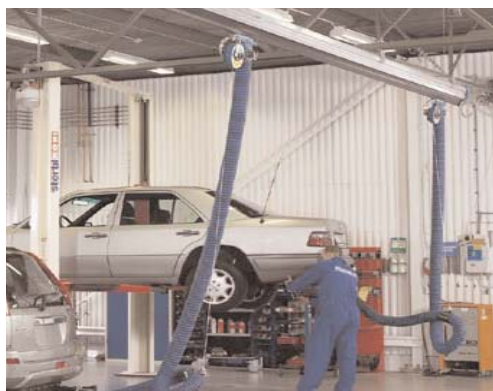
Installazione di Canalina Blindotubo con gruppi di aspirazione mobili.
