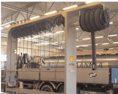
Stazione di manutenzione con arrotolatori per la distribuzione di aria, acqua, olio, grasso e per l'aspirazione di gas di scarico.
